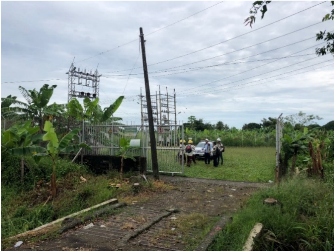
Ilustración 8. Subestación de Energía Nueva Colonia a 110kV (Foto: EPM)
