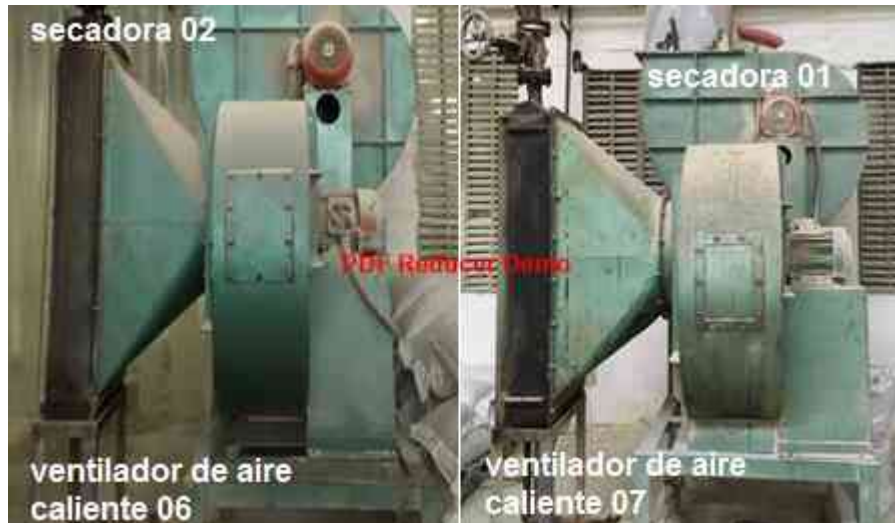
Figura 109. Ventiladores de aire caliente.
