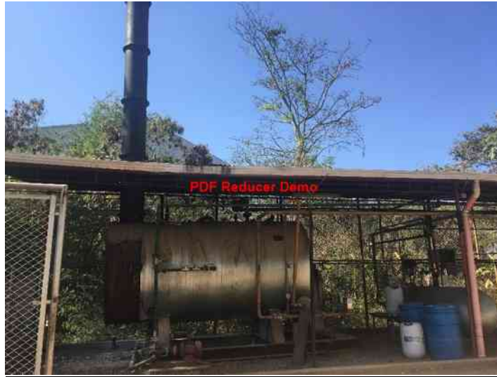
Figura 113. Caldera piro tubular.
