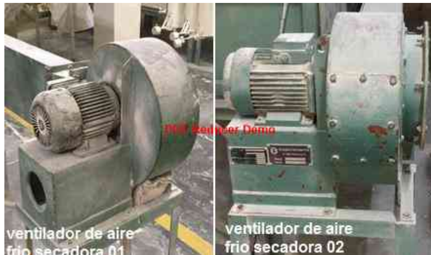
Figura 110. Ventiladores de aire frio.
