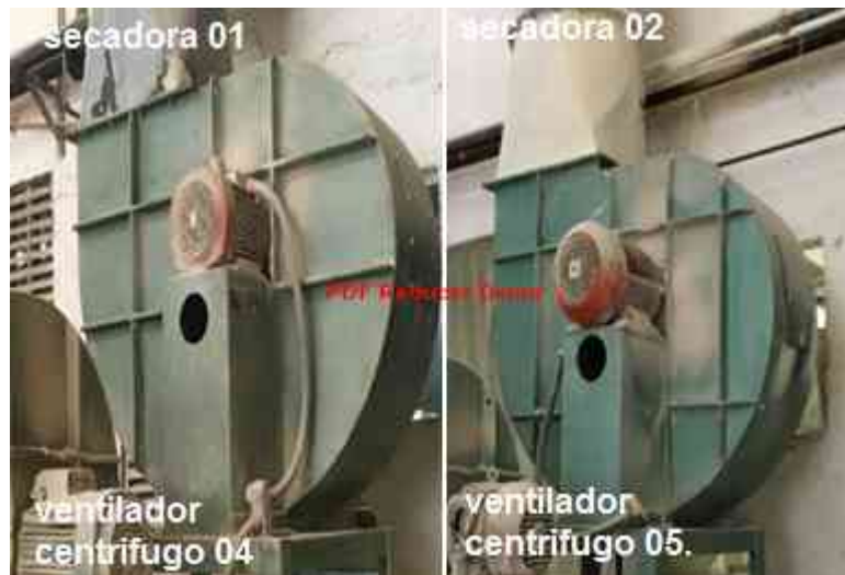
Figura 104. Ventiladores centrífugos secadoras.
