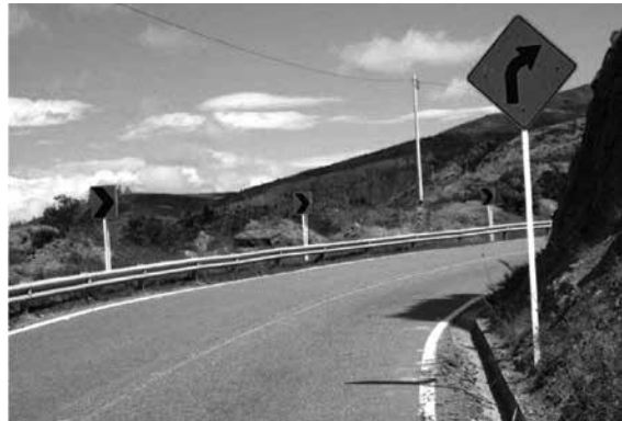
Fig. 3. Señales verticales muy cerca del borde del pavimento, taludes críticos.
