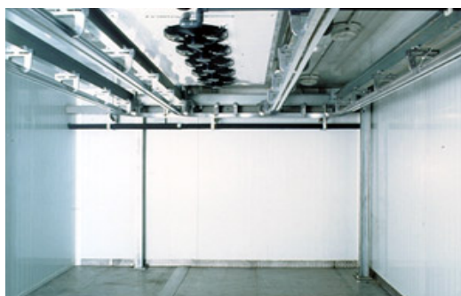
Figura 12. Cuarto Frío y/o cámara frigorífica
