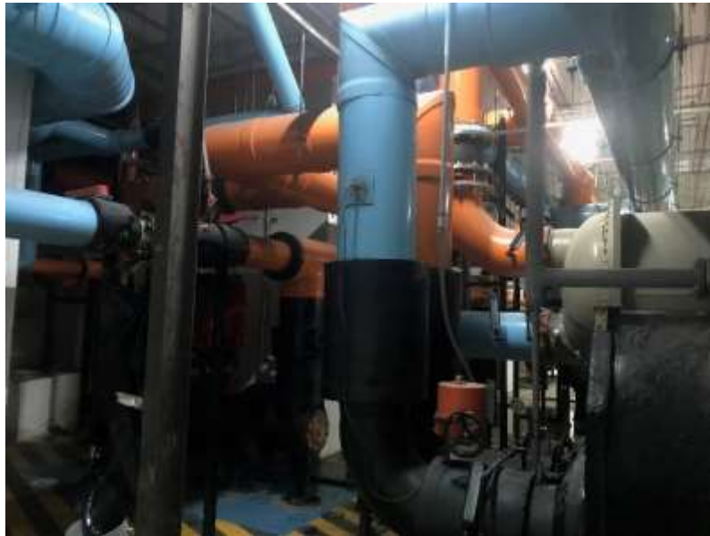
Gráfica 8. Cuarto de Chillers antes. Parte 3.
