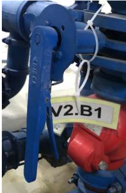
Gráfica 14. Cuarto de Bombas después. Parte 1.
