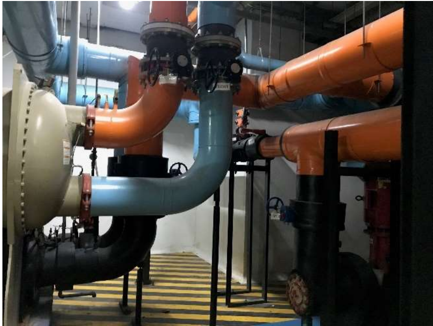
Gráfica 10. Cuarto de Chillers después. Parte 2.
