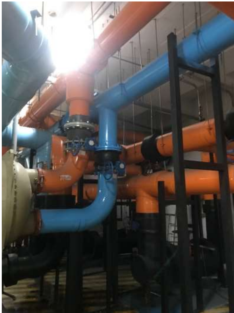
Gráfica 6. Cuarto de Chillers antes. Parte 1
