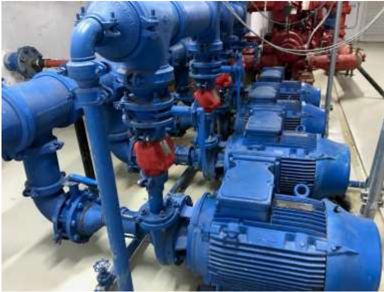
Gráfica 13. Cuarto de Bombas antes. Parte 2.
