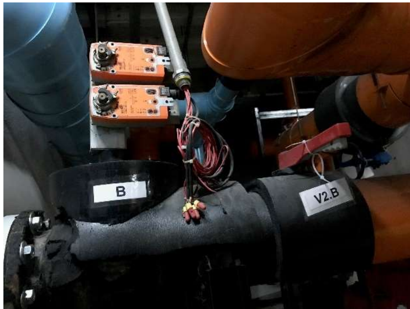
Gráfica 11. Cuarto de Chillers después. Parte 3.
