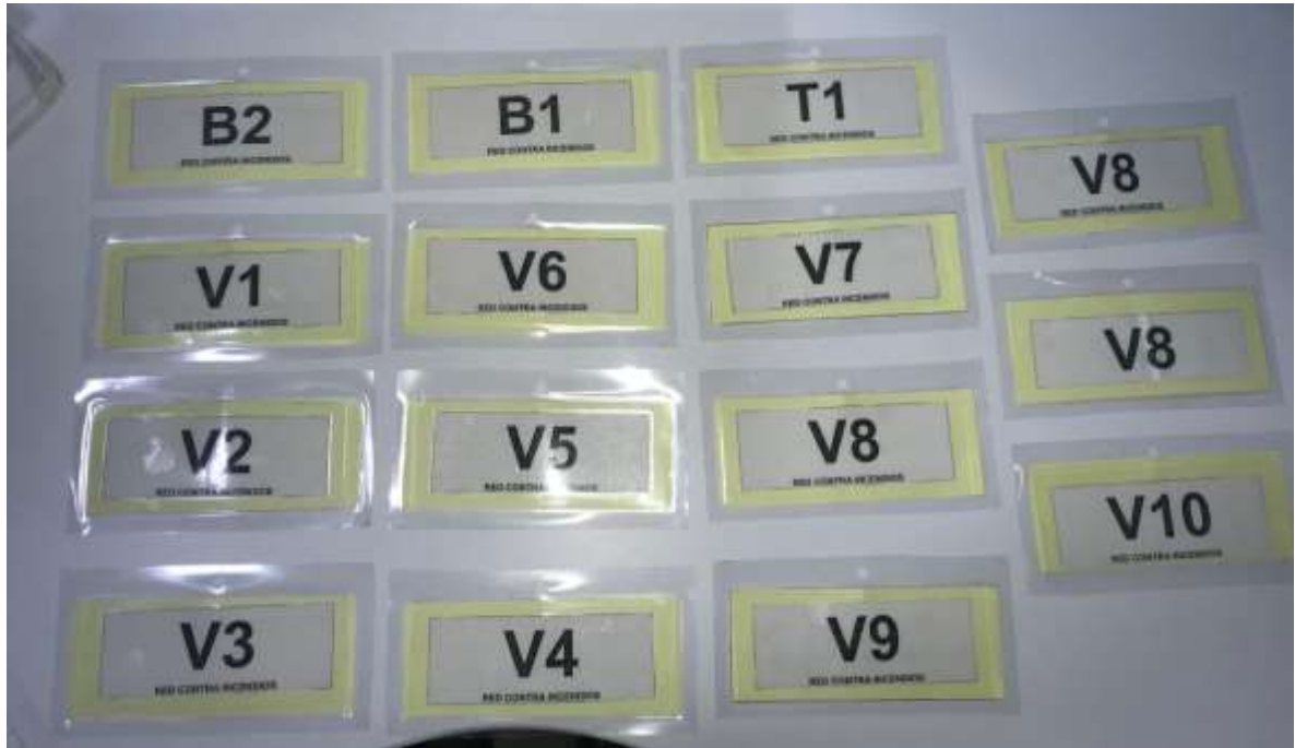
Gráfica 17. Señalización cuarto red contra incendios
