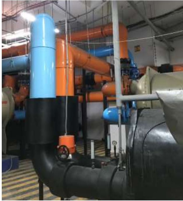
Gráfica 7. Cuarto de Chillers antes. Parte 2.
