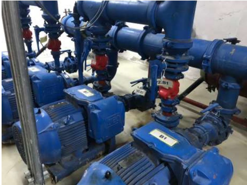
Gráfica 16. Cuarto de Bombas después. Parte 3.
