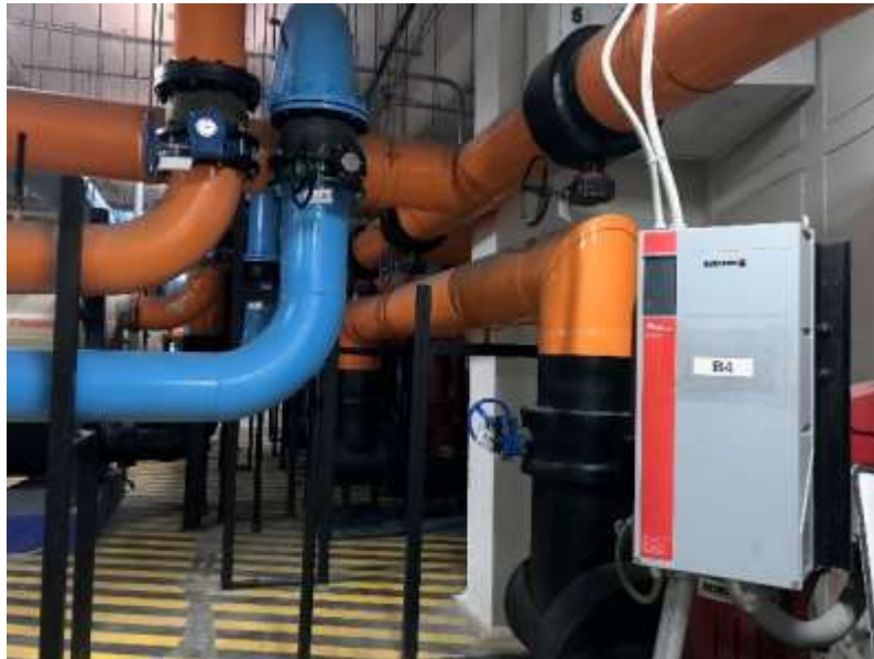
Gráfica 9. Cuarto de Chillers después. Parte 1.
