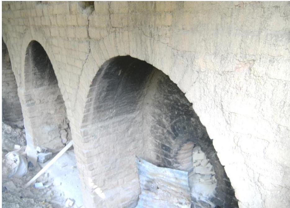
Fotografía 12. Orificios de Entrada del Horno Pampa Para el Material Combustible
