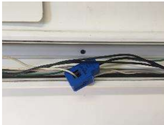
Figura 56. Medición de la corriente por el sensor SCT-013.
