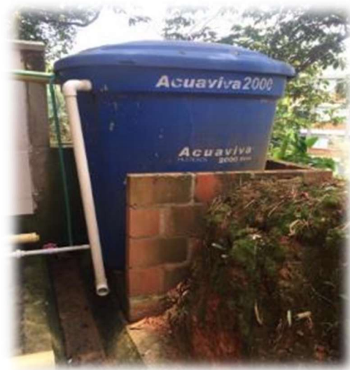
Figura 11. Tanque de almacenamiento.
