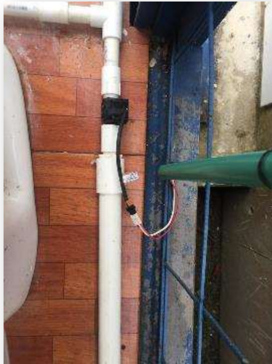
Figura 48. Caudalímetro N°2, instalado en la salida de distribución de agua lluvia.
