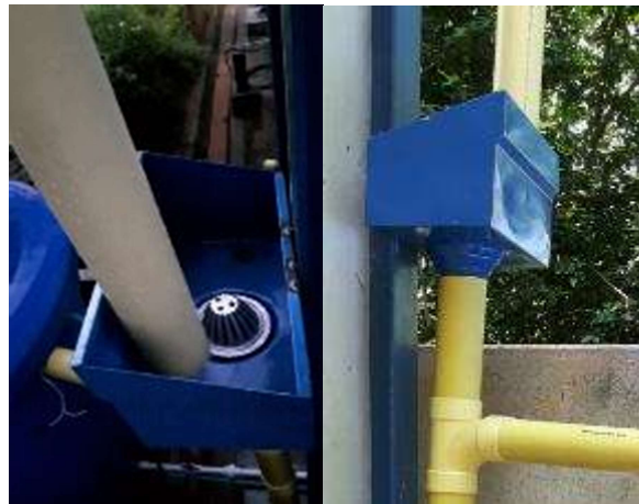
Figura 9. Filtro del tanque de almacenamiento.
