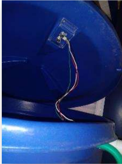
Figura 37. Sensor de nivel instalado.
