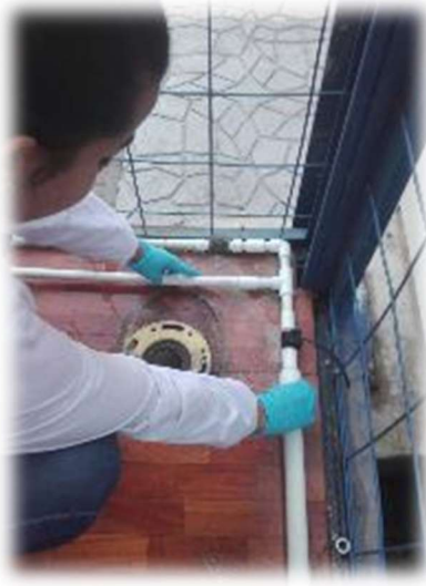
Figura 29. Instalación de Caudalímetro
