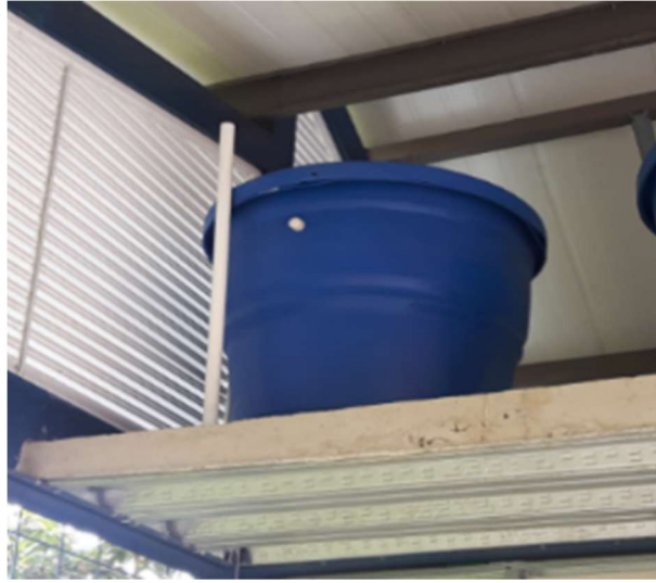
Figura 12. Tanque elevado res de agua lluvia.
