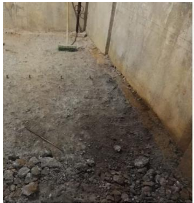
Ilustración 13 Escarquilamiento de la Z11.
