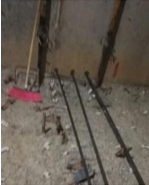
Ilustración 16 Anclajes al muro en el eje A con varillas de 7/8" de diámetro a lo largo de viga.
