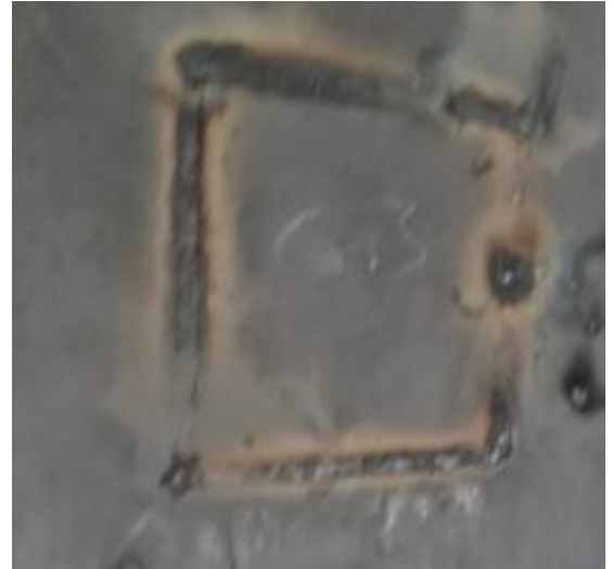
Ilustración 57 Cordón de soldadura de fondeo inicial (6010) en la ventana de la platina.
