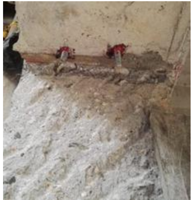
Ilustración 39 Incrustación del perno enroscado en la parte superior de la Cara No 4 relleno de epoxico HILTI RE-500.
