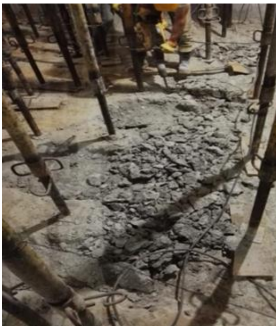
Ilustración 12 Escarquilamiento de la Z8.
