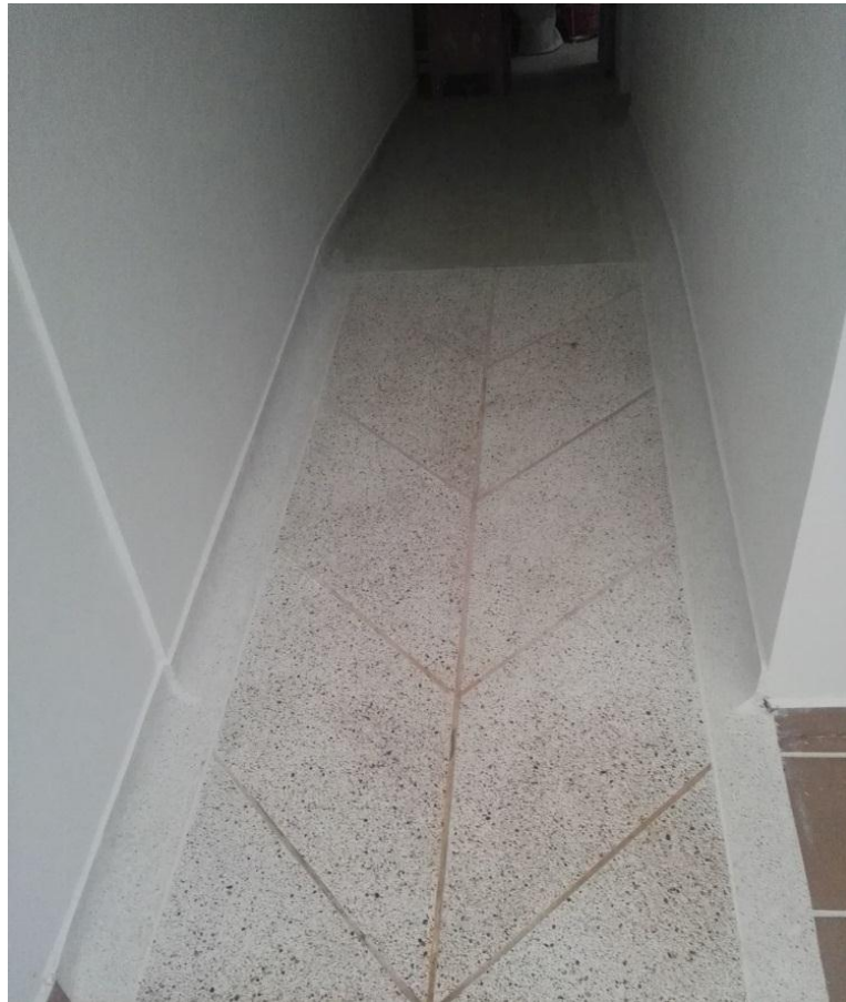
Ilustración 87 Rampa de acceso para zona de lavado en forma de espina de pescado en gravilla lavada.
