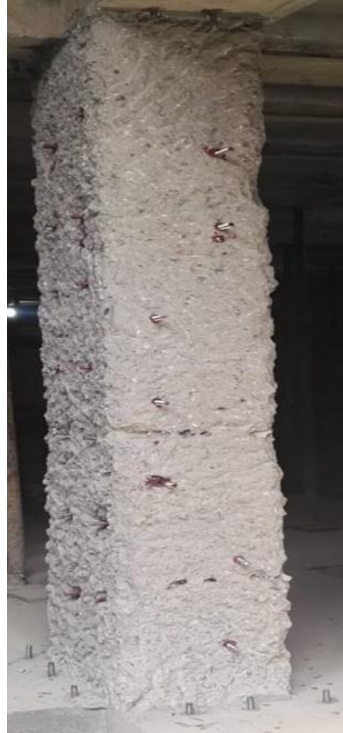
Ilustración 36 Incrustación de los pernos roscados en la Cara No 4 relleno de epoxico HILTI RE-500.
