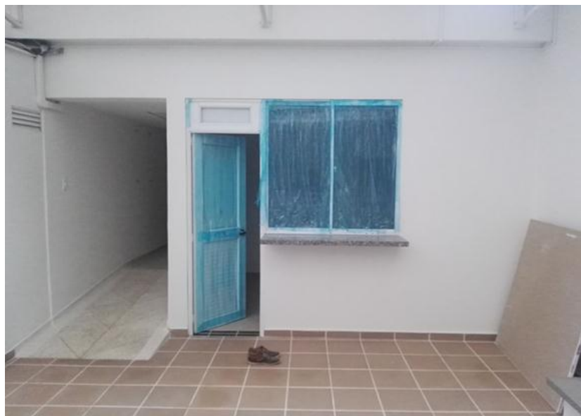
Ilustración 95 Estado final muro cafetería.
