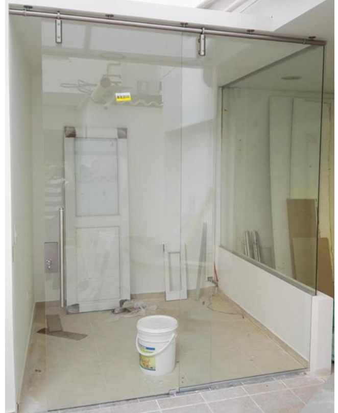
Ilustración 91 Puerta corredera y ventana en vidrio templado para la oficina de atención al usuario.
