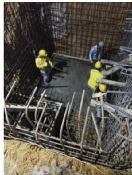
Ilustración 8 Fundida del piso del cuarto de máquinas
