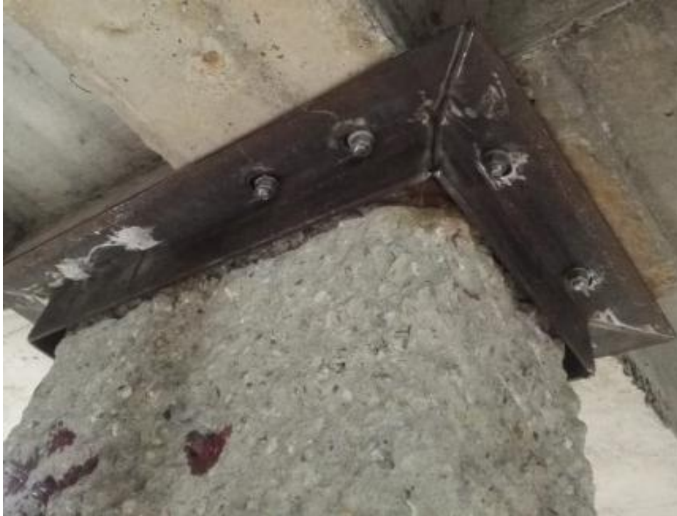
Ilustración 43 Instalación de la lámina superior vista desde la Cara No 1 y 2 con su respectivo ángulo.
