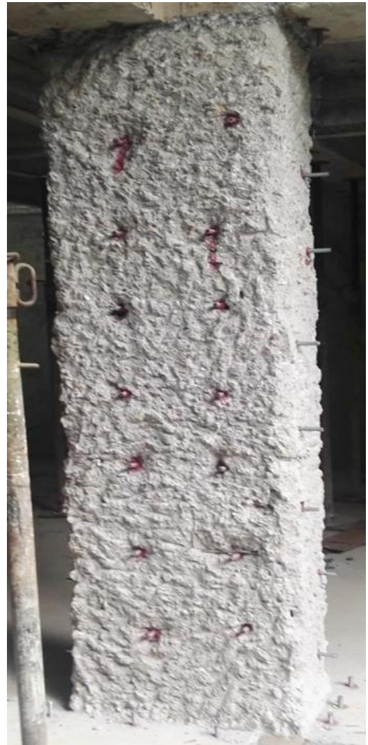
Ilustración 34 Incrustación de los pernos roscados en la Cara No 3 relleno de epoxico HILTI RE-500.
