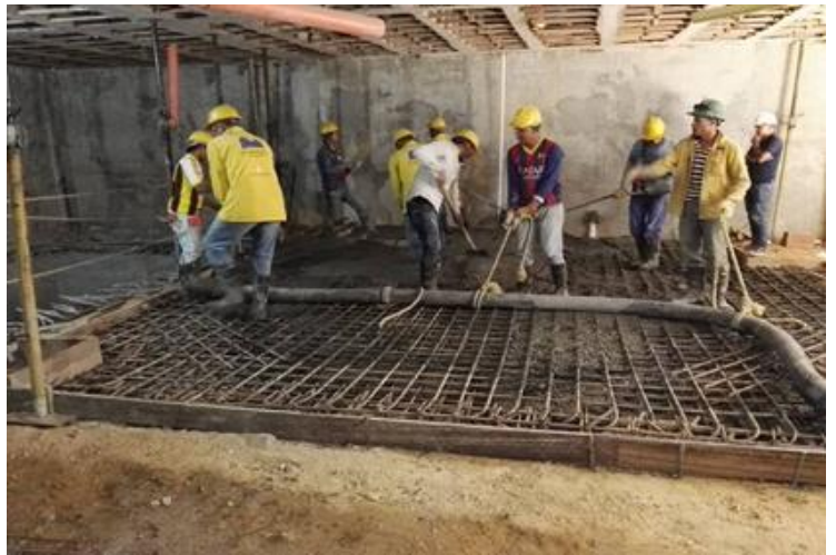
Ilustración 27 Fundida de la tapa del tanque de almacenamiento.
