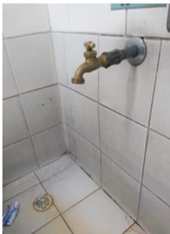
Ilustración 9. Fugas presentadas en el lavamanos de los baños de operarios de planta
