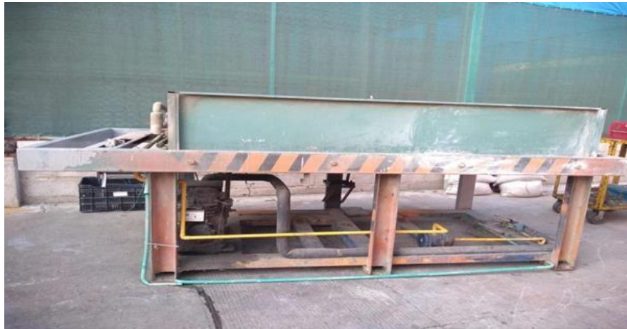
Ilustración 13. Sistema de refrigeración Chiller 15 HP con R-22
