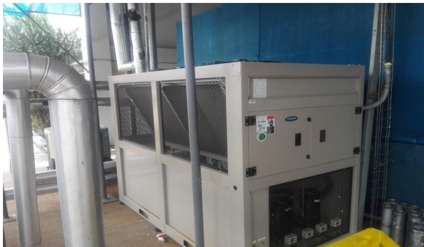
Ilustración 14. Sistema de refrigeración Chiller 15 HP CON R-410A
