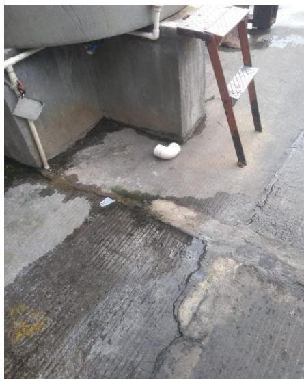
Ilustración 10. Fuga presente en la tubería del tanque de almacenamiento
