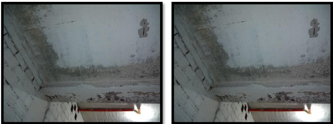
Figura 19 Corrosión presente por filtración en piscina en Alameda del Viento
