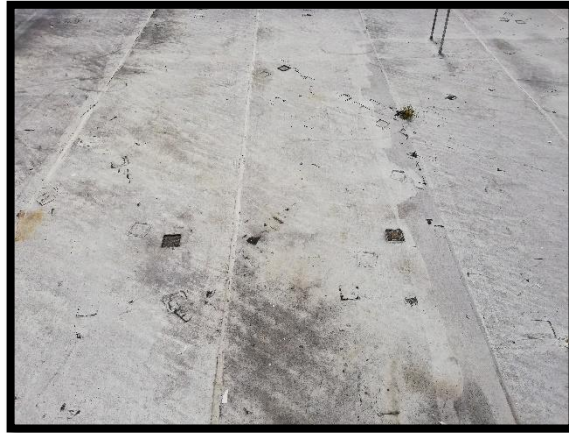
Figura 11 Perforación en manto asfáltico en conjunto residencial Germania
