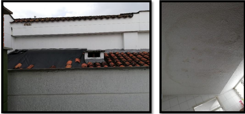
Figura 8 Filtración presente en cubierta en edificio 52 plaza
