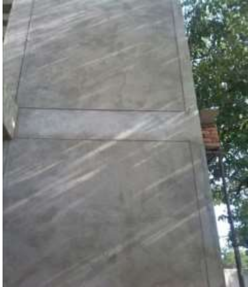
Imagen 20. Dilataciones en muros frontales
