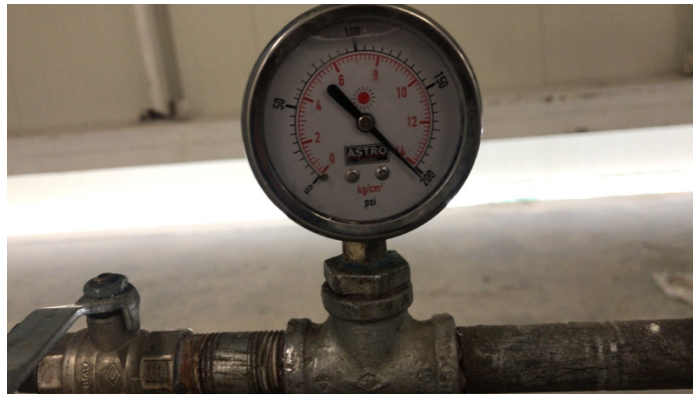
Figura 31. Manómetro de prueba. (Autor, 2018)
