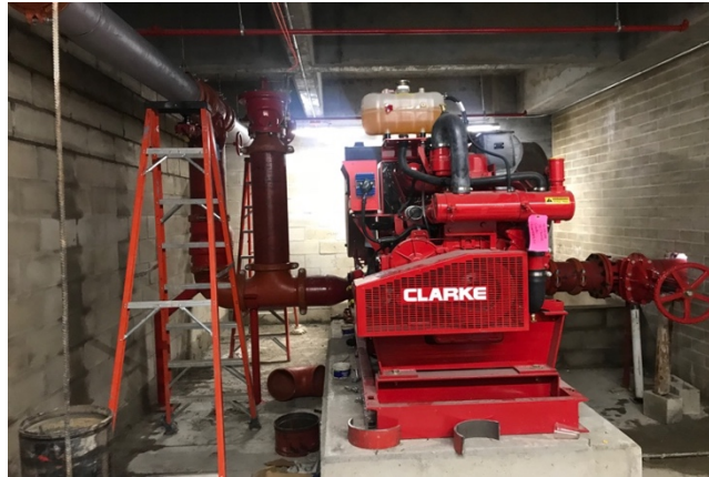
Figura 23. Bomba de ACPM para RCI. (Autor, 2018)
