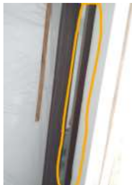
Figura 64. Faltante de 3cm de muro del apartamento 804.
