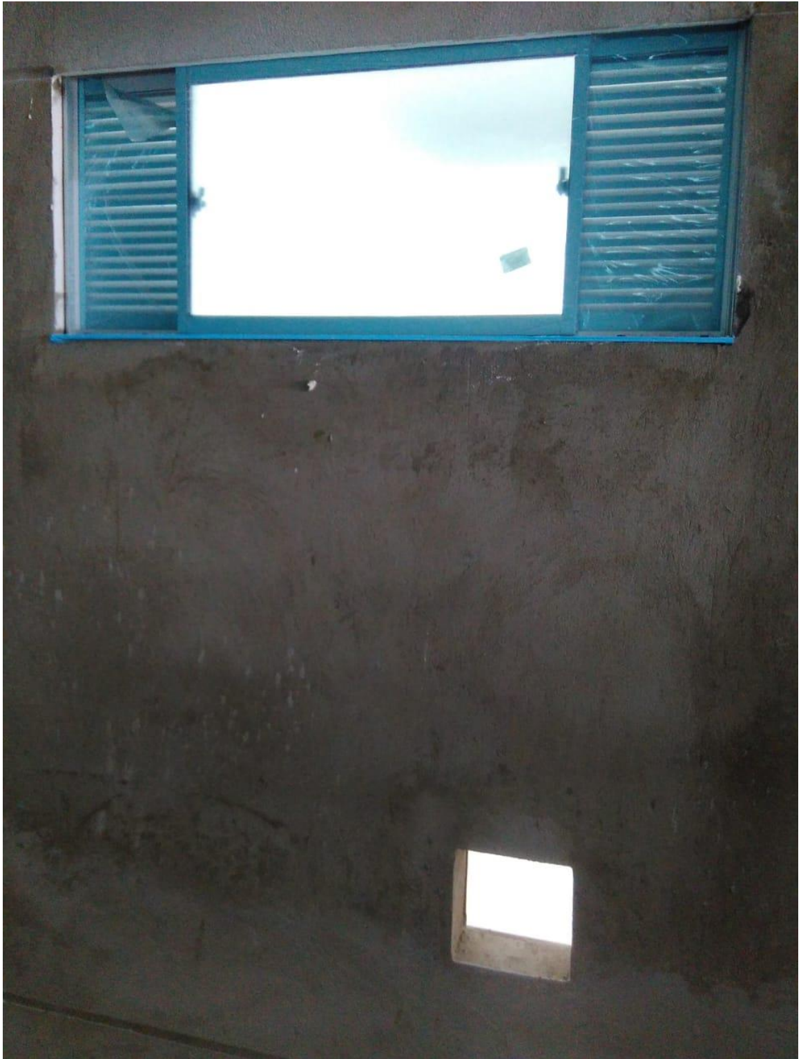
Imagen 19. Rejillas usadas para la ventilación del recinto.
