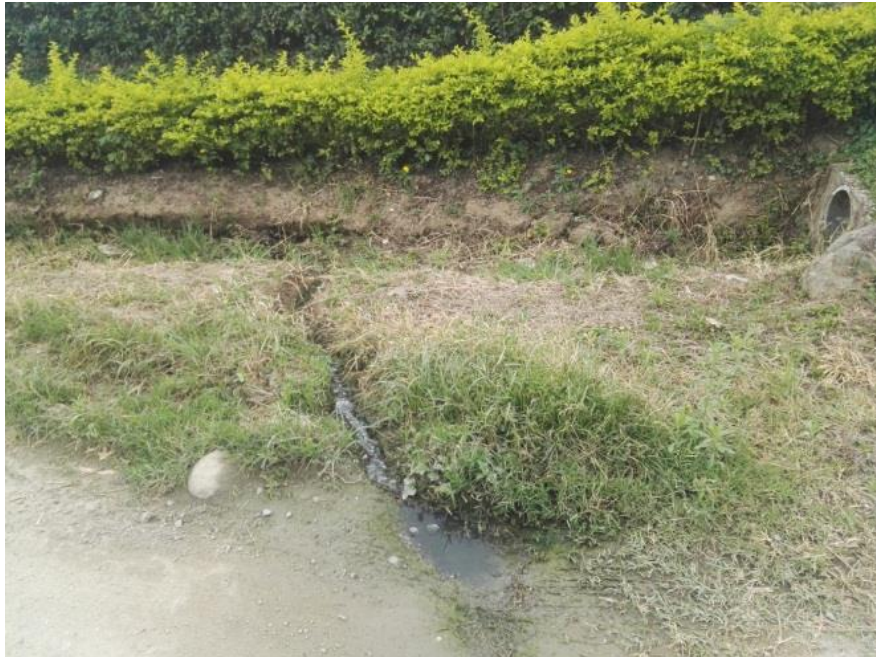
Figura 15. Afloramientos de aguas residuales por las vías.
