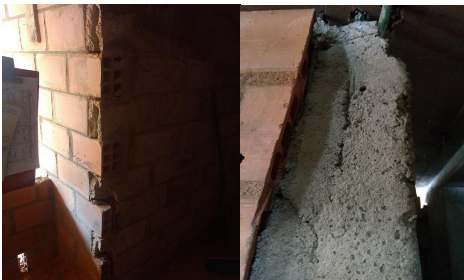
Ilustración 7. Mampostería y columnetas en mal estado.
