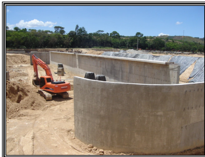
Fotografía 10. Tanque de Aireación
