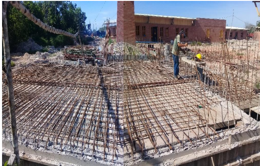
IMAGEN 27 Tanque de almacenamiento de agua de la PTAP – Proyecto DICAR Fuente: Propia
