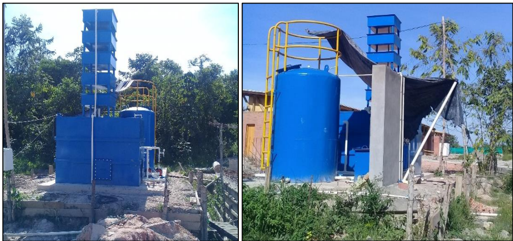
IMAGEN 24 Planta de tratamiento agua potable PTAP – Proyecto DICAR Fuente: Propia
