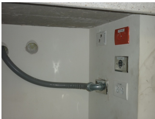
Figura 40. Conexión eléctrica principal.
