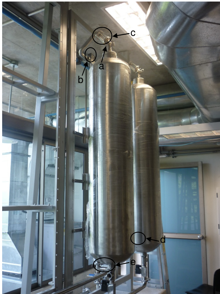
Figura 15. Tanques de Calibración.
