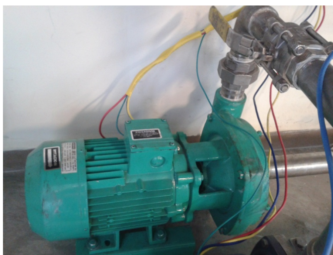
Figura 16. Bomba centrífuga de 2 HP.
