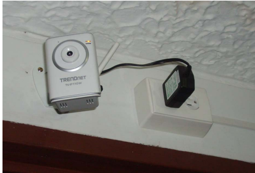
Figura 25. Ejemplo de una cámara TRENDnet TV-IP110W instalada.
