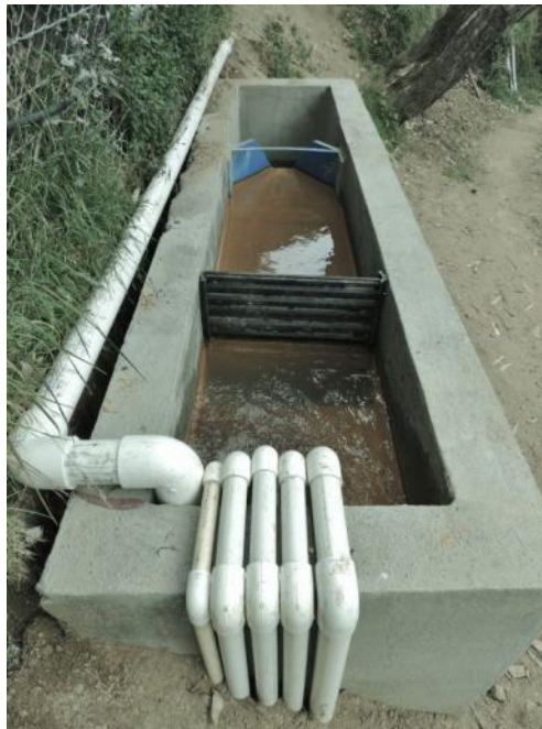
FOTOGRAFÍA No: 06 LUGAR: Bodega La Peter OBSERVACIONES: Estación de monitoreo – Canaleta H para aforo de caudales
