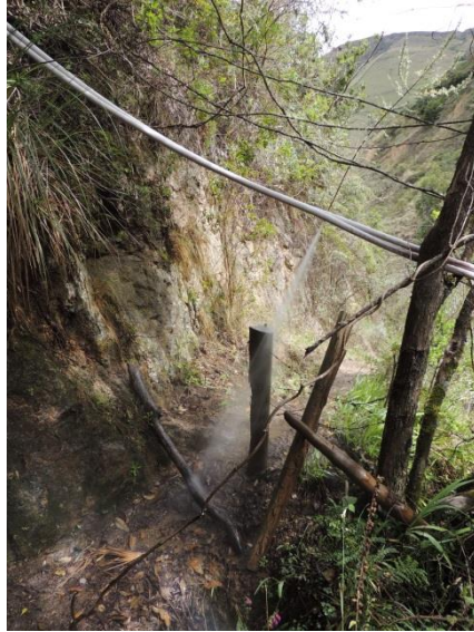
FOTOGRAFÍA No: 23 LUGAR: ED OBSERVACIONES: Supervisión de líneas de conducción de aguas
