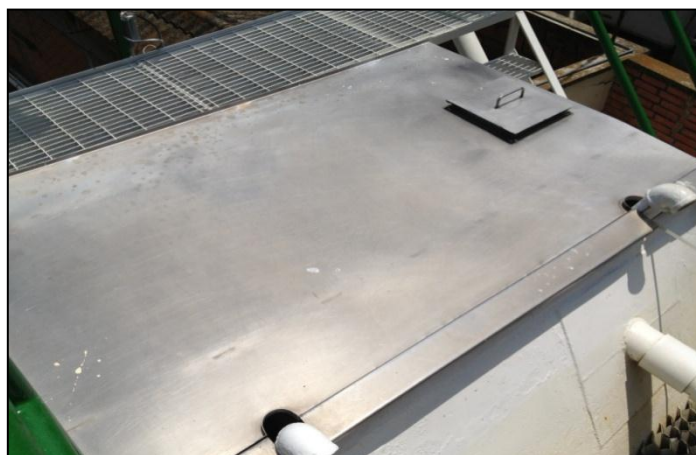
Imagen 23. Tanque de Almacenamiento
