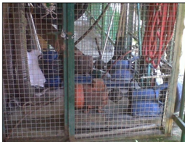
Imagen 19. Sistema de Bombeo
