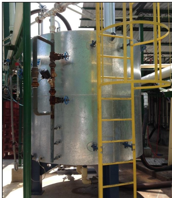
Imagen 30. Tanque de almacenamiento del lodo
