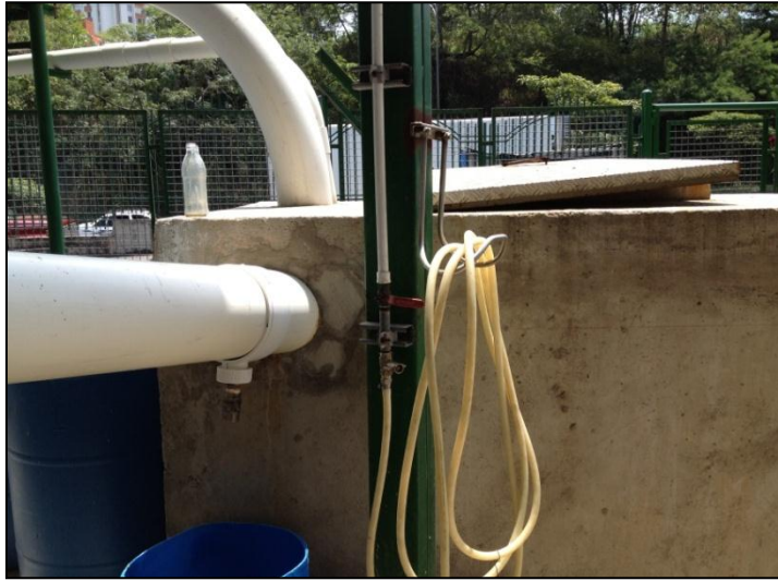
Imagen 29. Entrega del agua al sistema de alcantarillado
