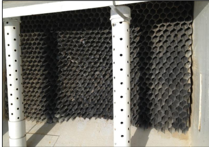
Imagen 22. Sistema de filtración
