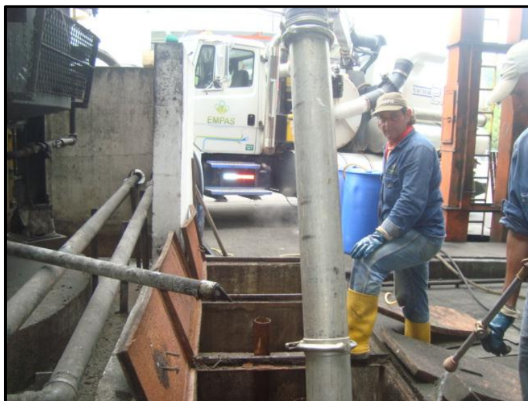
Figura 8. Limpieza de trampa de grasas EMPAS.
