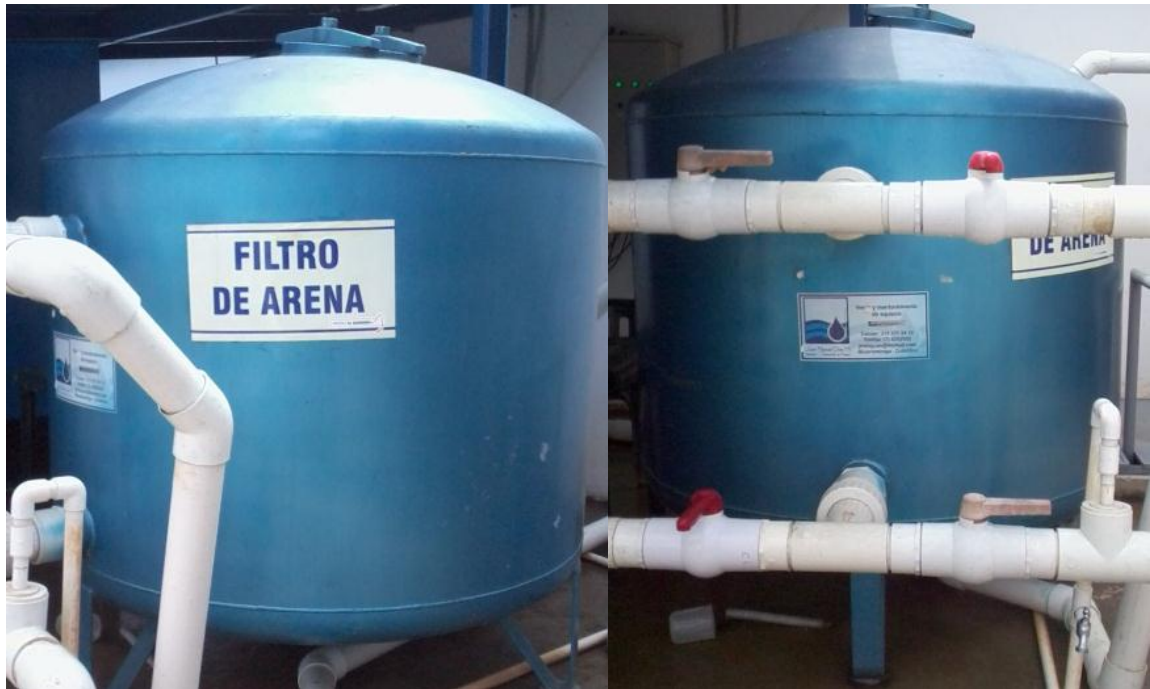
Fotografía 5. Filtro de Arena
