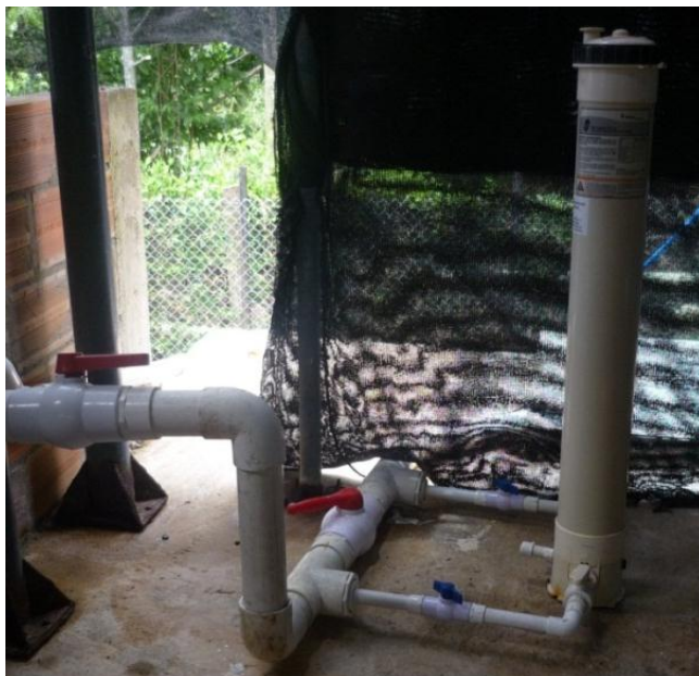
Fotografía 6. Dosificador del cloro en pastillas
