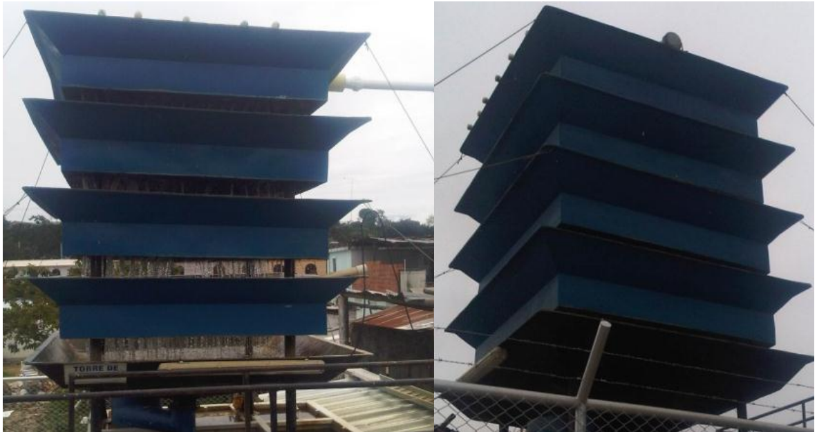
Fotografía 2. Torre de Aireación
