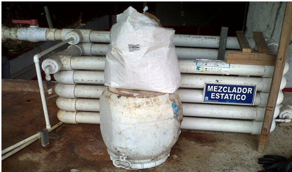
Fotografía 10. Serpentín de mezcla rápida
