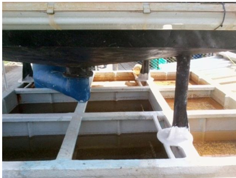
Fotografía 3. Tanque de Coagulación - Floculación
