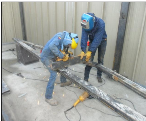
Imagen 24. Estructura en perfil de acero
