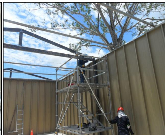
Imagen 25. Estructura en perfil de acero
