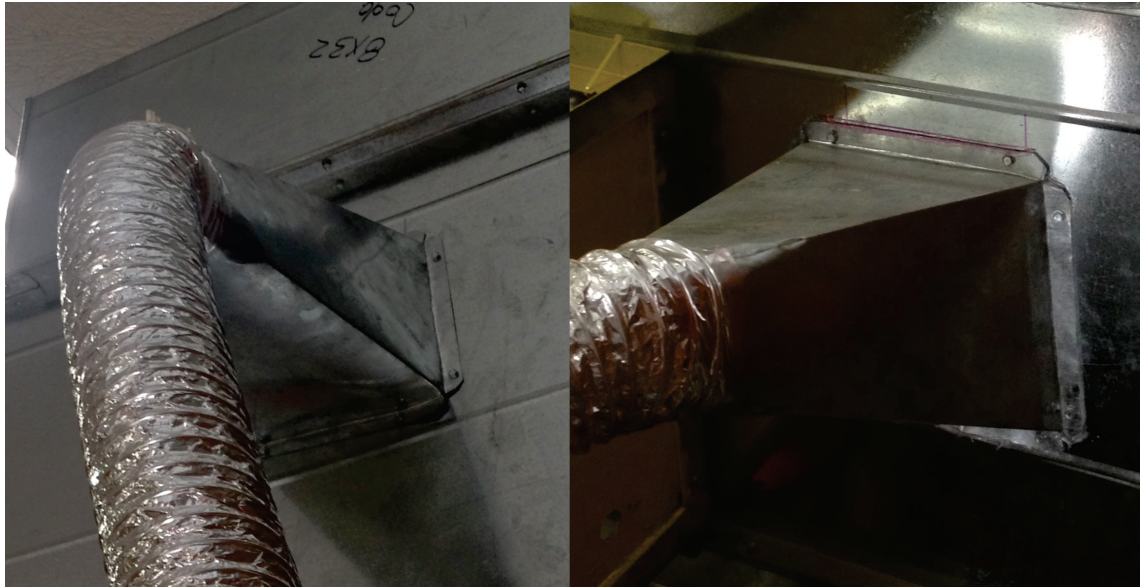
Figura 3.1.: Campanas de acoplamiento al sistema de almacenamiento y acondicionamiento de aire.
