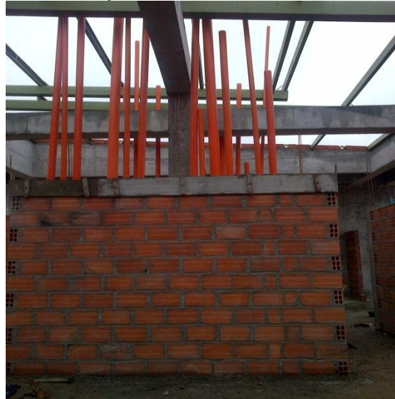
Puntos de gas-agua
