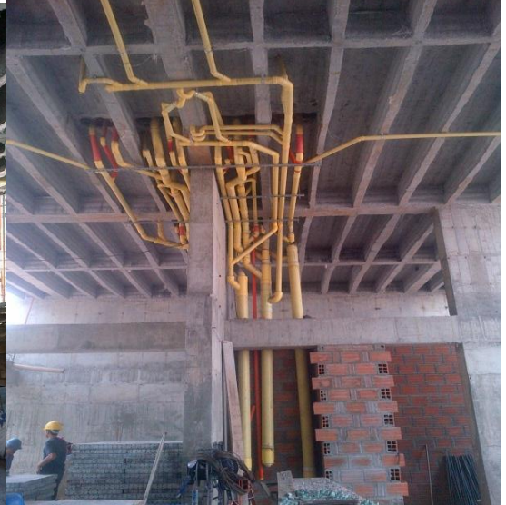
Arañas y bajantes del lobby
