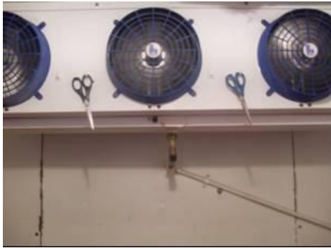
Imagen 22. Tijeras ubicadas de forma inadecuada
