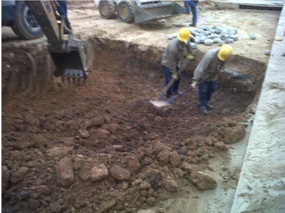
Figura 70 Fallo existente. Profundidad 70 cm.
