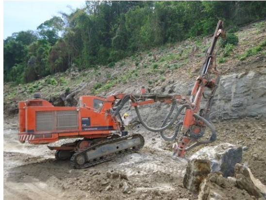
Fotografía 42-Actividades de perforación con equipo Tamrock 780, para posterior procedimiento de voladura, en el sector K18+150 al K18+250 MI.
