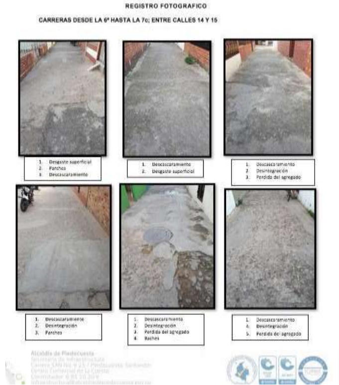
Figura 24: Inspección visual pavimento Rígido
