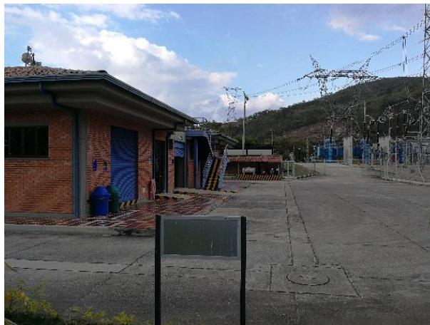
Imagen 19 – Visita subestación Ocaña 1.
