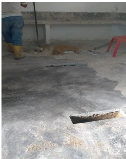
Imagen 6 – Desnivel placa de piso colegio Rafael Uribe Uribe.
