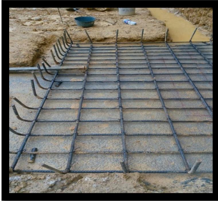
Ilustración 14: Medición de separación de hierros en parrilla inferior de cimentación edificio Millenium zapata D6
