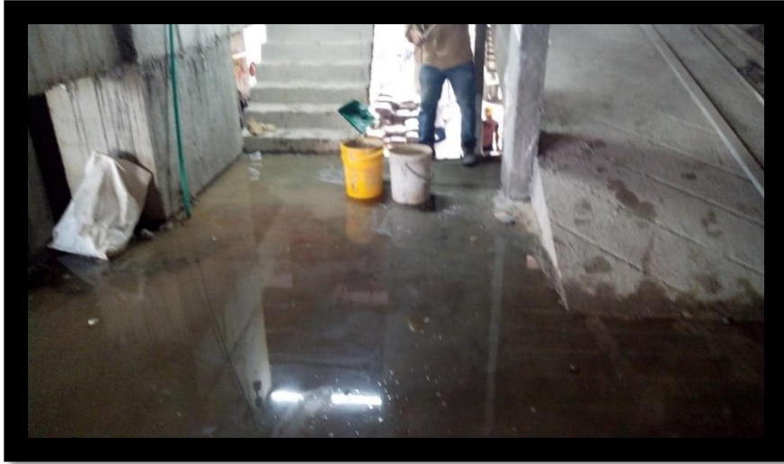
Ilustración 21: Humedad en semisótano edificio Premium Gold
