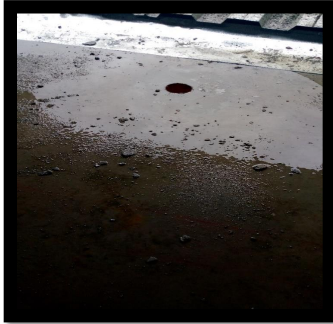
Ilustración 18: Sifones provisionales para la disposición de aguas lluvias, piso 1
