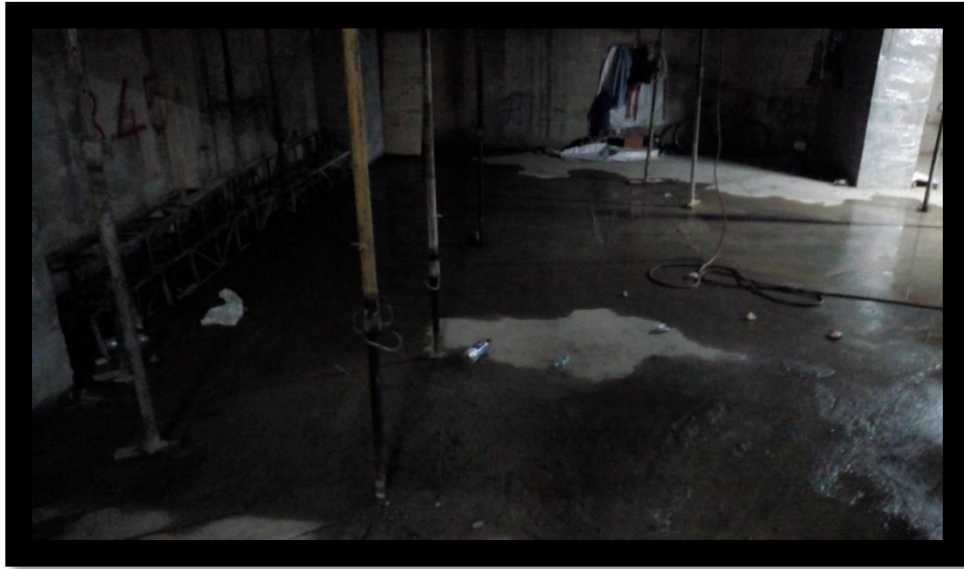
Ilustración 169: Humedad en el sótano 1 edificio Premium Gold
