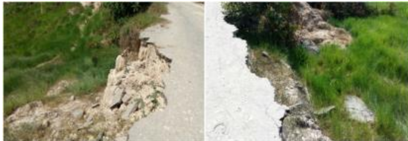
Ilustración 21. Daños en la banca de la vía que conduce a la vereda Mata de piña
