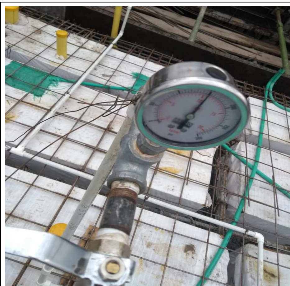
Figura 38. Prueba hidráulica probada por medio del manómetro y llaves de paso. Fuente: PROINSAN S.A.S.
