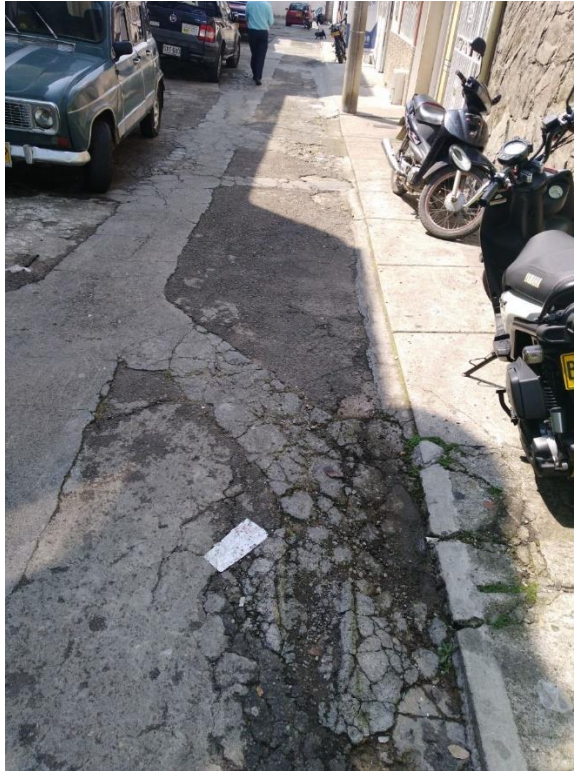
Figura 14. Pavimento de Calle 6 en deterioro por acometida realizada al lugar, lo que se observa en la foto un descascaramiento, parches en asfalto y concreto.
