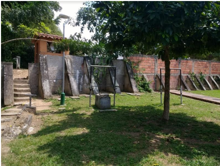
Figura 3. Estado actual Gimnasio al Aire libre del conjunto Paragüitas Real.
