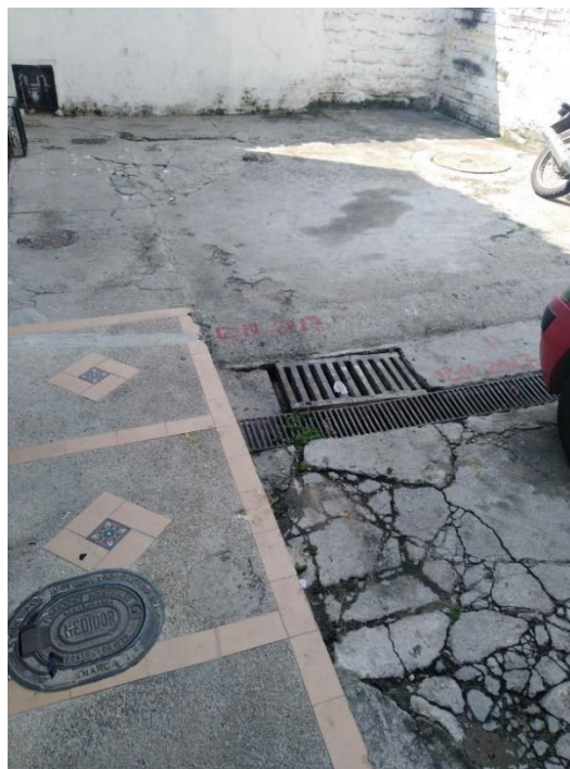
Figura 15. Estado de la Calle 6 en deterioro se observa grietas en bloque.
