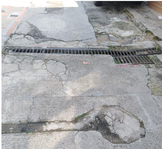
Figura 13. Estado de la Calle 6 en deterioro se observa grietas en bloque y mal estado de las rejillas de sumideros.
