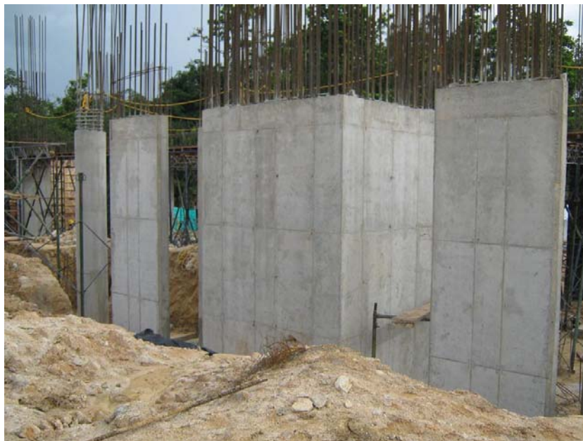
Figura 22. Pantallas y Foso de Ascensor
