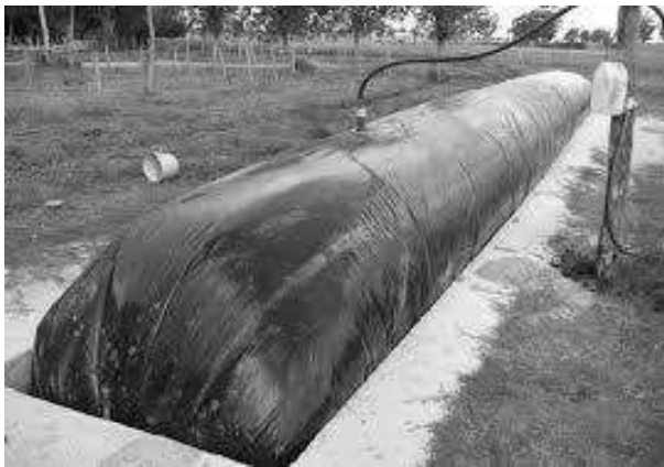
Figura 8, Biodigestor de polietileno
