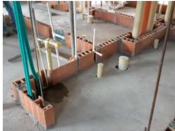
Fotografía 10. Redes eléctricas, sanitarias y desagüe
