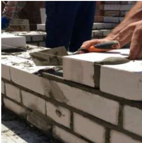
Fotografía 5. Mampostería sucia en bloque de concreto
