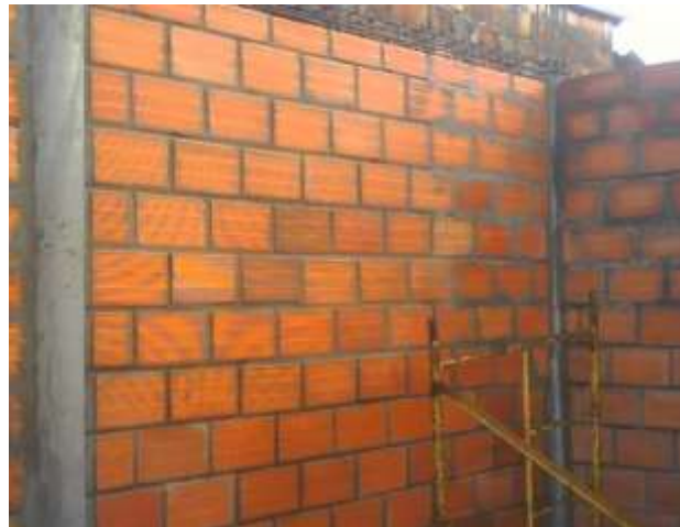
Fotografía 6. Mampostería sucia en ladrillo de arcilla
