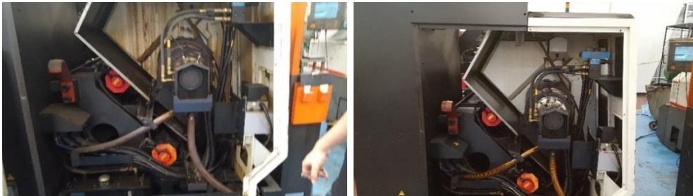
Figura 19 y 20. Antes y después de la unidad hidráulica.
