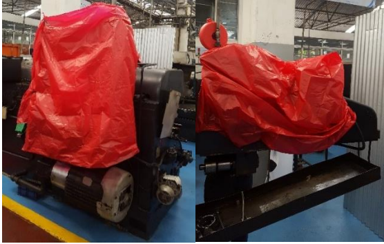
Figura 1 y 2. Aislamiento de partes eléctricas con plástico y aplicando LOTO.
