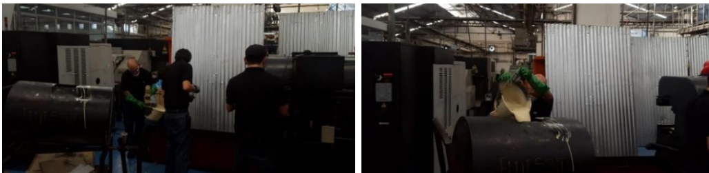
Figura 13 y Figura 14: Extracción en la máquina y depósito en el tanque, del refrigerante contaminado de aceite.
