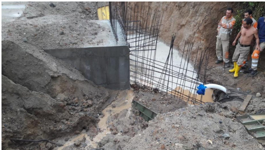
Figura 15. Inundación box coulvert Km 86+242.
