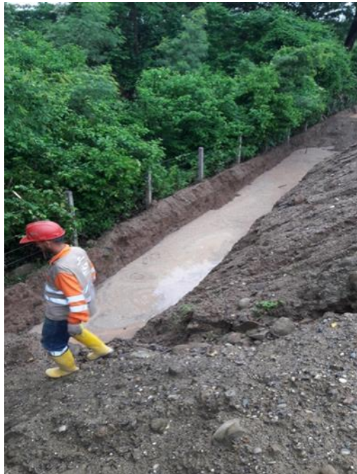
Figura 16. Inundación en la excavación del muro patero 79+800.
