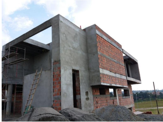
Imagen 35 - Elementos descolgados en fachada lateral
