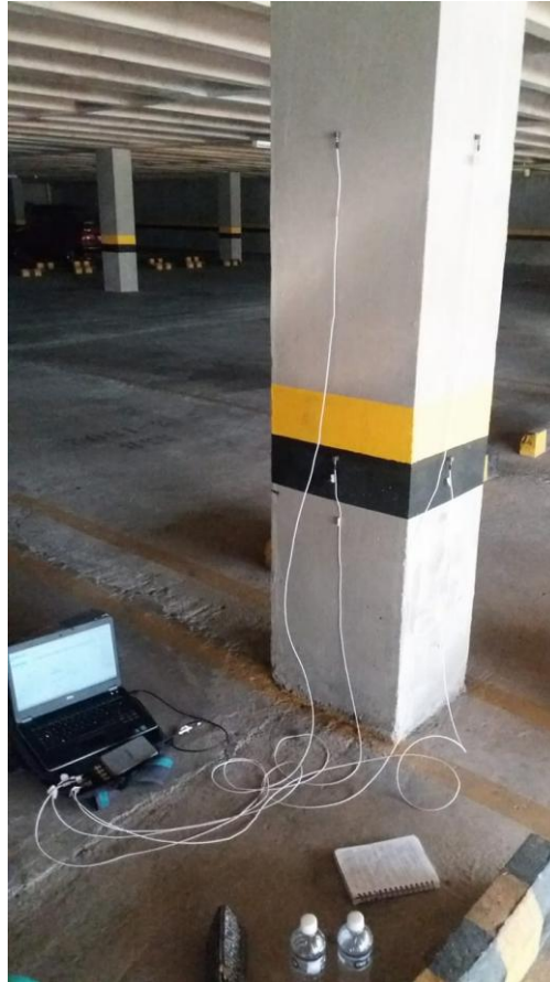
Figura 14: Columna con el equipo instalado
