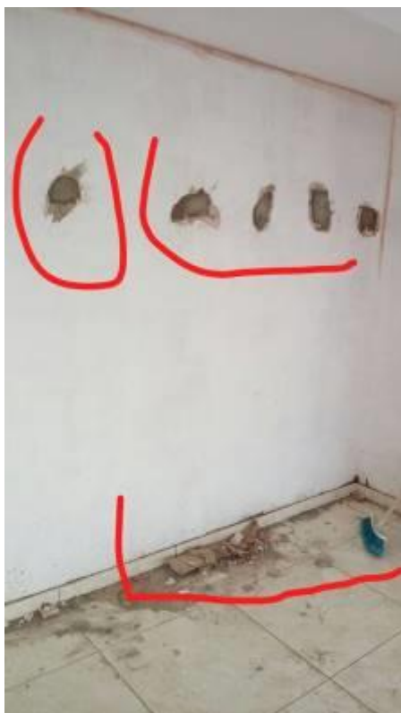
Figura 10. Resanes por Vacío Interno
