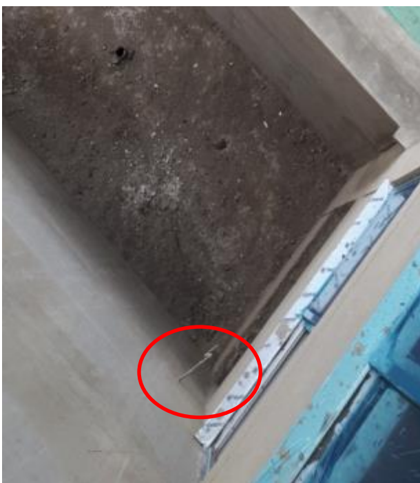
Figura 12. Resanes por Varillas
