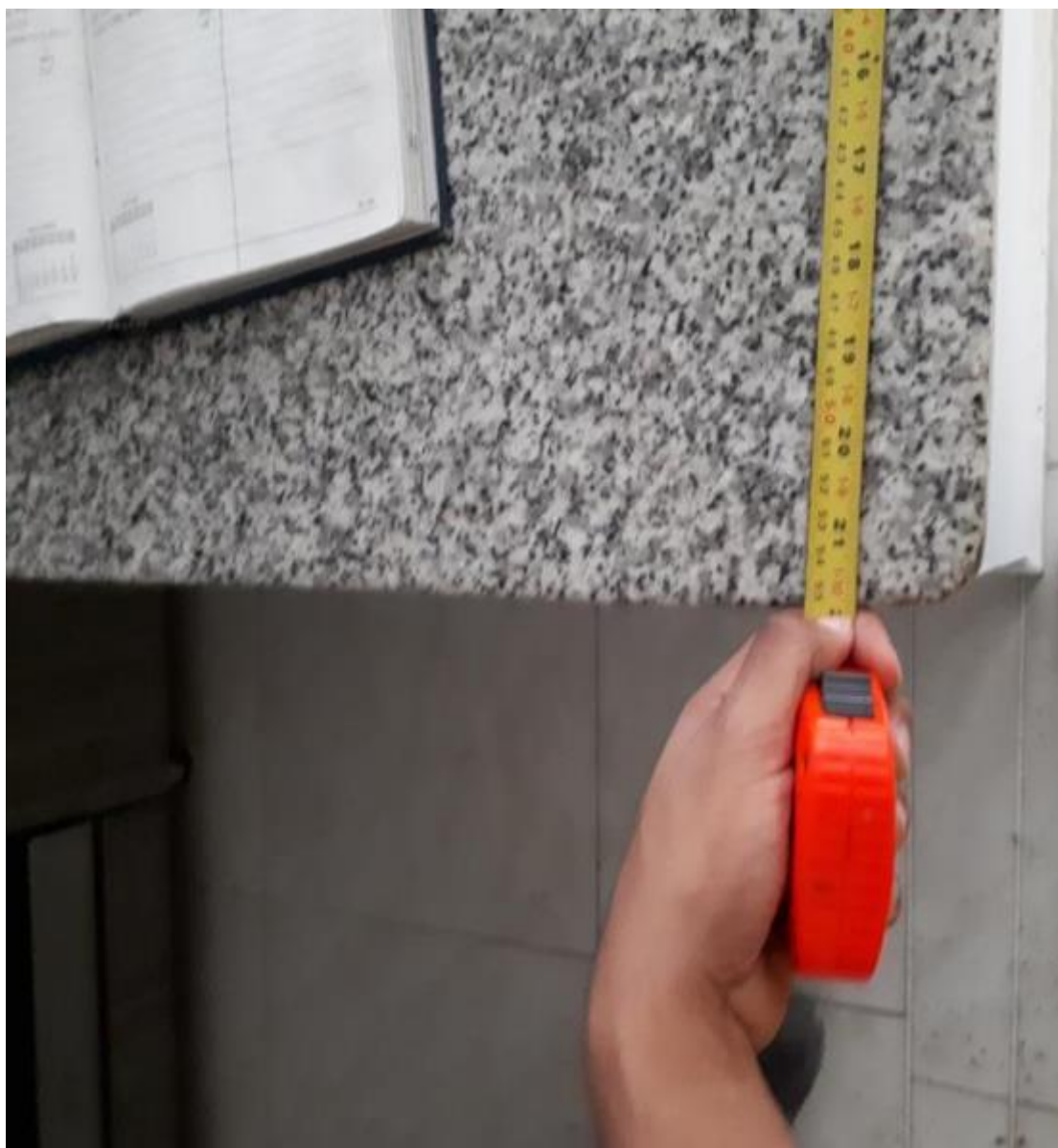
Figura 26. Revisión Muro Cocina Apto Modelo
