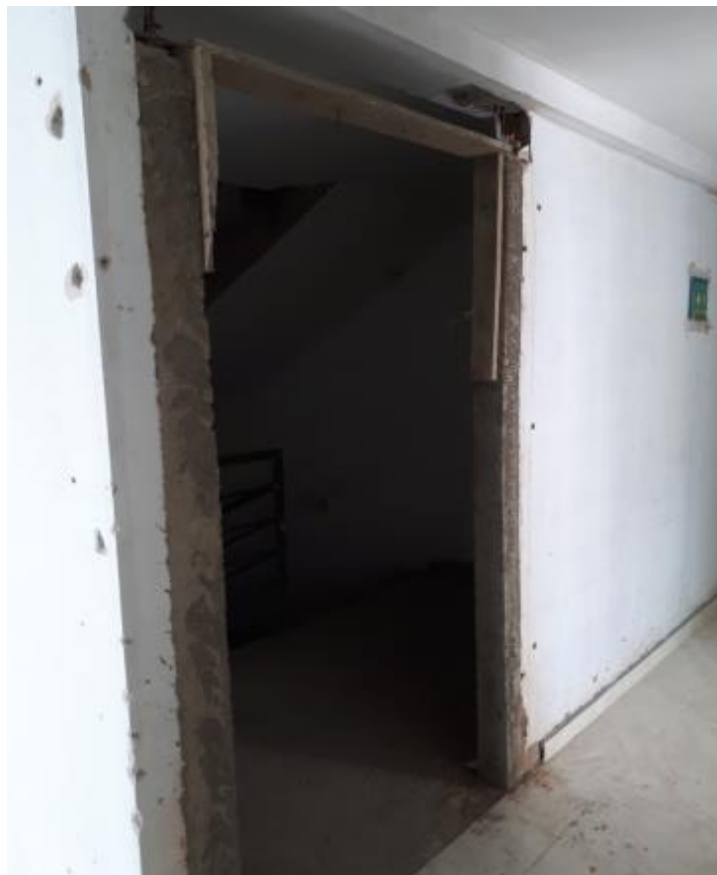
Figura 38. Corte de Mampostería y Ausencia de Columnetas de Soporte en Escalera de Emergencia Tipo II
