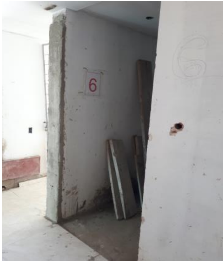
Figura 37. Falta Alineamiento Mampostería con Pantalla en Escalera de Emergencia Tipo I
