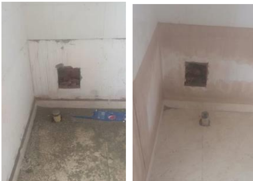
Figura 22. Afectación de Tubería Hidráulica
