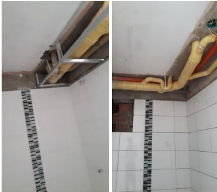
Figura 25. Retraso en Estructura Dry Wall
