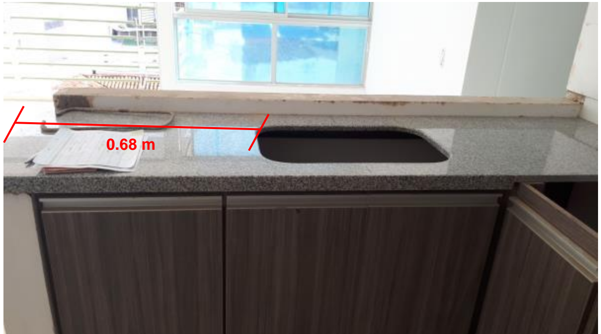
Figura 30. Ausencia de Toma Eléctrico en Mesón.
