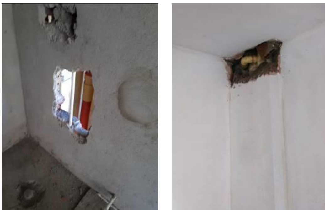
Figura 8. Resanes Tubería Rota en Buitrones
