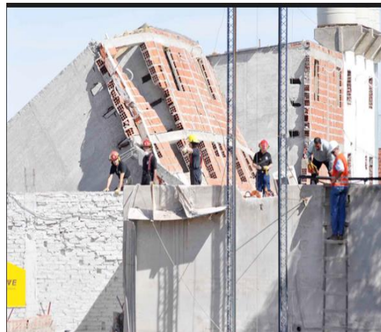
Figura 2: Consecuencias de asentamientos diferenciales.
