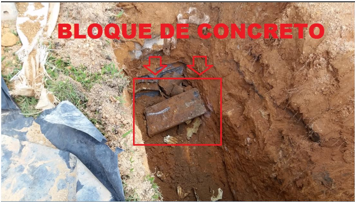
Imagen 31 Bloque de concreto encontrado en la tubería de red de alcantarillado.
