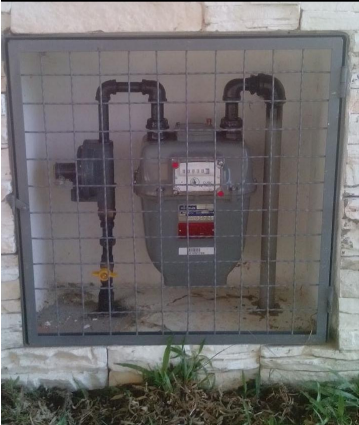
Imagen 40 Centro de medición finalizado.
