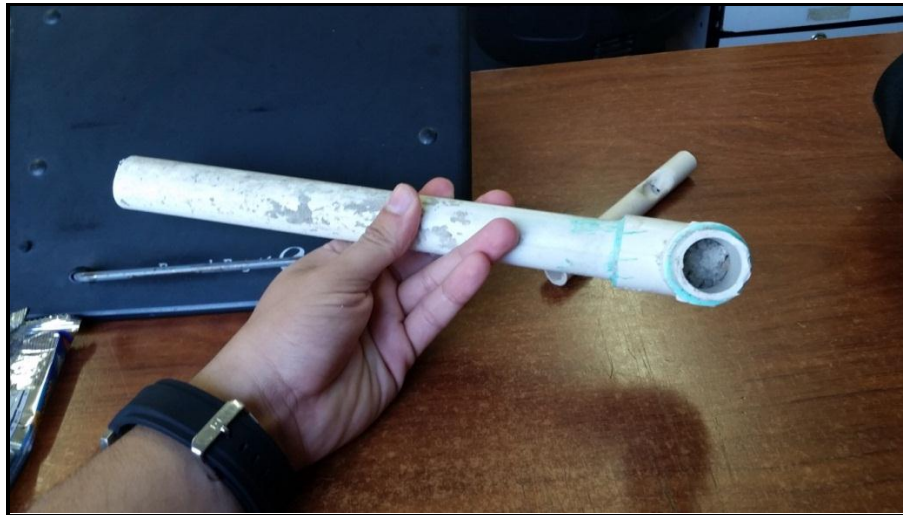
Imagen 33 Filtración de mezcla presentada en tubería de agua fría
