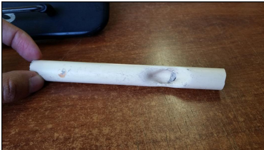
Imagen 34 lesión en tubería por golpe con cincel.
