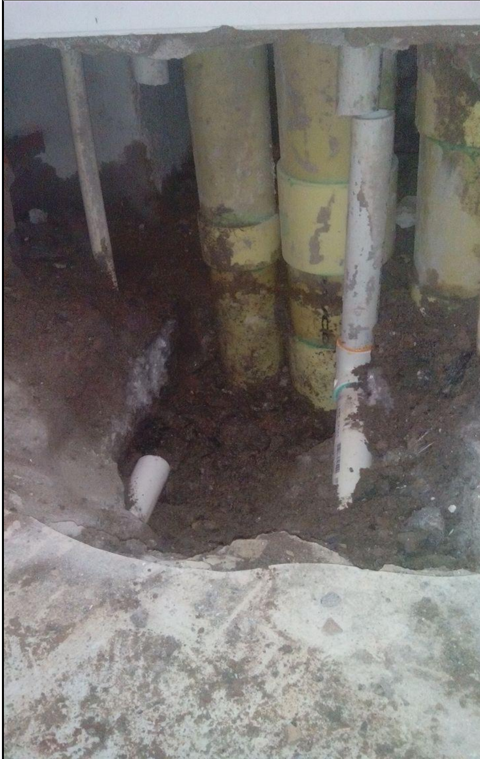
Imagen 32 Fuga presentada en tubería de agua fría por instalación de mampostería
