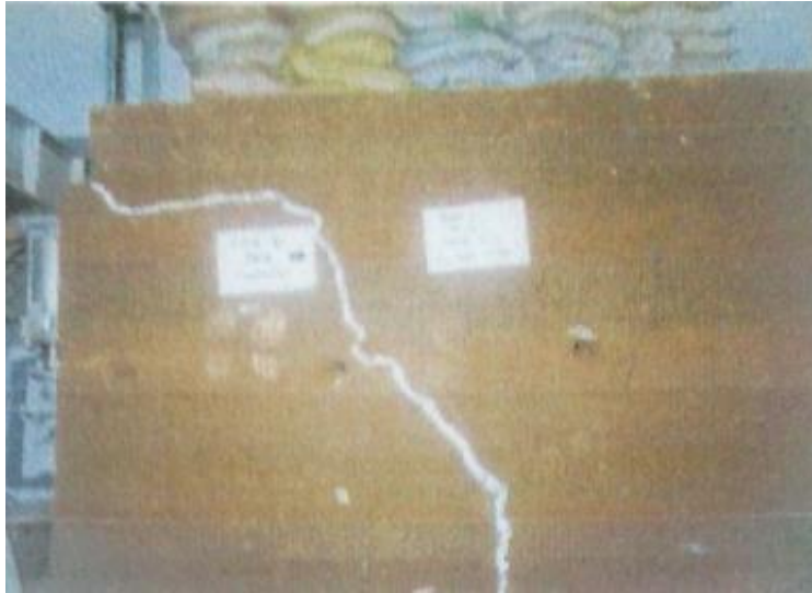
Figura 27 Daño local muro en tierra zona superior izquierda (Ubicación del gato hidráulico) (Prada Díaz & Rivero Bolaños, 2000)
