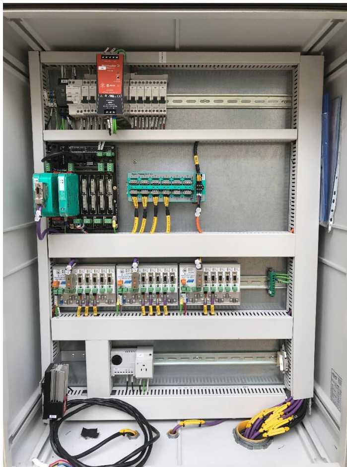
Figura 23. Gabinete de Bus de Campo
