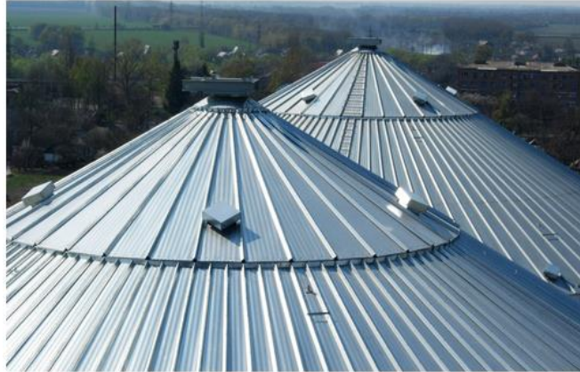
Figura No.6: Techados del Silo Fuente: http://pradosilos.com/
