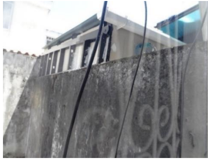
Imagen 25. Estado actual del predio identificado con GDT 4298-1. Aislamiento posterior construido.
